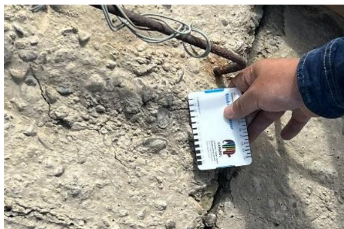
Fig. 5. Identificación de ancho de la fisura en loseta
