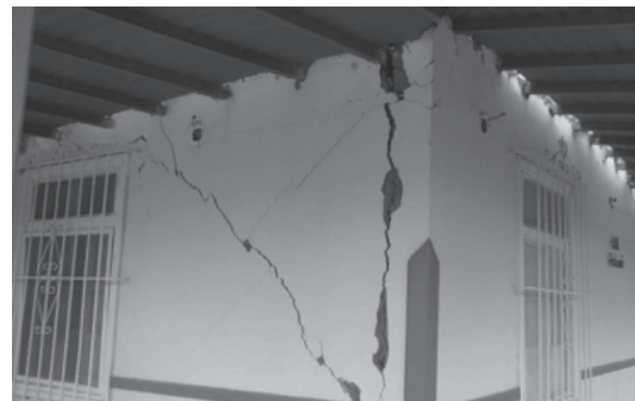
Figura 9. Daños en muros de adobe por esfuerzos sísmicos [16].
