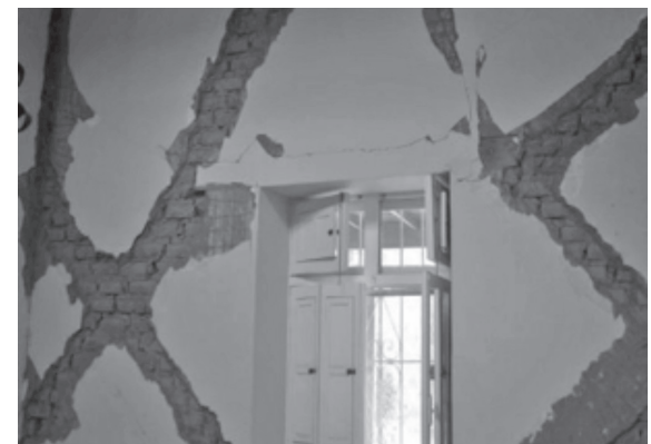
Figura 10. Daños en muros de adobe por esfuerzos sísmicos [16].
