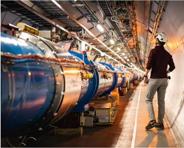
Figura 2. En este tramo del anillo subterráneo de 27 kilómetros del LHC, se pueden observar los tubos por donde circulan los haces de partículas subatómicas a velocidades cercanas a la luz (LHC Deutschland, s. f.).
