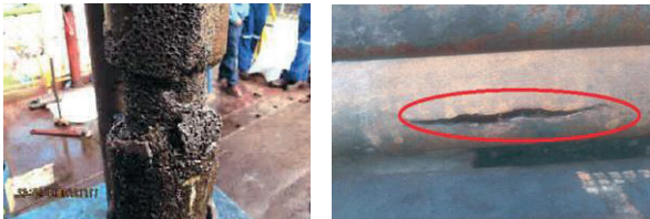
Figura 6. a) Sólidos en a entradas de las bombas, b) Huevo en tubería. Fuente: Petroamazonas EP.
