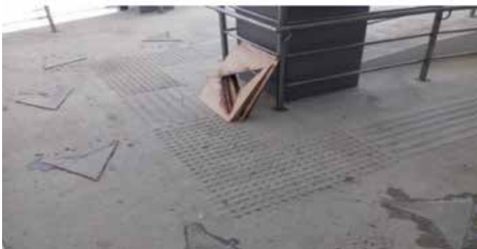
Figura 10. Señalética de seguridad elaborada con mezcla M2 colocada en las rampas de acceso y emergencia en el Coliseo 3000 de Machala.
