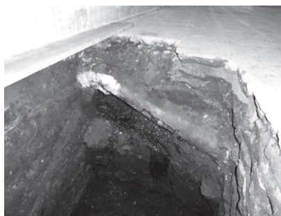
Tubería rota, filtraciones de agua
