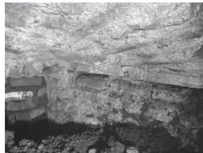
Vano tapiado, ingreso a las criptas que están detrás de la nave lateral sur de la iglesia (unidad 2)
