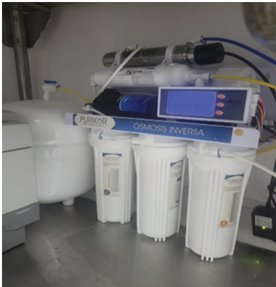
Figura 1. Sistema de filtros de osmosis inversa instalados en la clínica universitaria.
